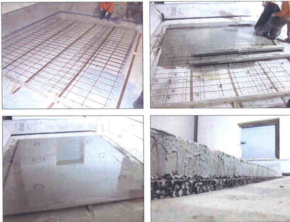
Imágenes 3, 4, 5 y 6 Detalles de la construcción de la losa y colocación de los paneles Copopren®
